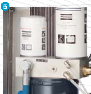
Filtr oleju i separator oleju
